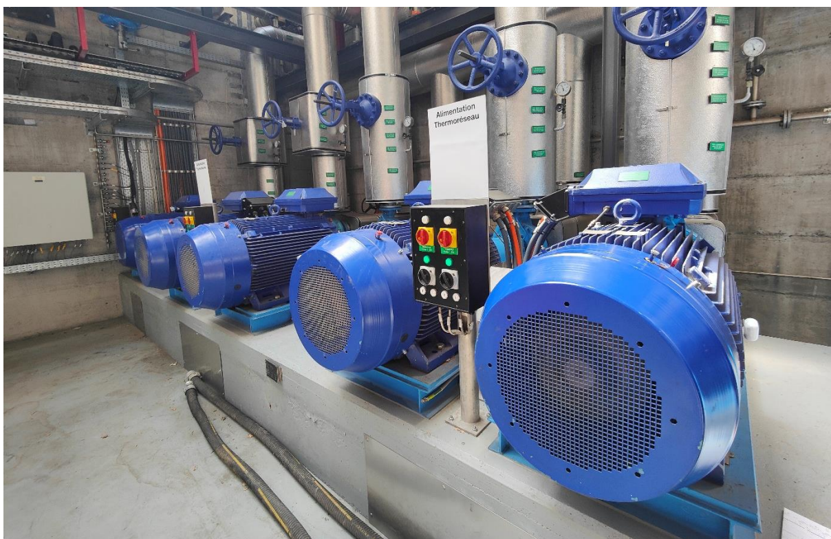
Figure 24 : Pompes actuelles pour la distribution du CAD
